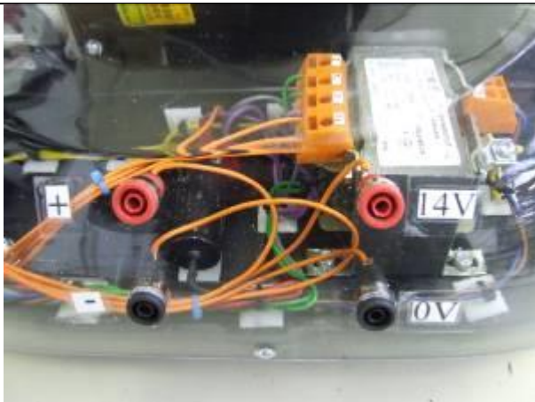
Transformateur + redresseur + Condensateur
