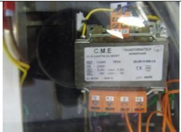
Transformateur abaisseur 230V / 14V / 8,5V
