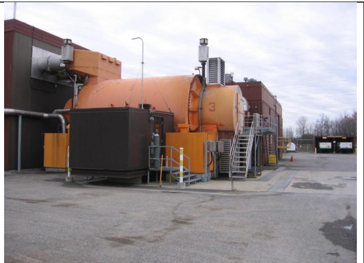
Machine synchrone utilisée en compensateur d'énergie réactive
