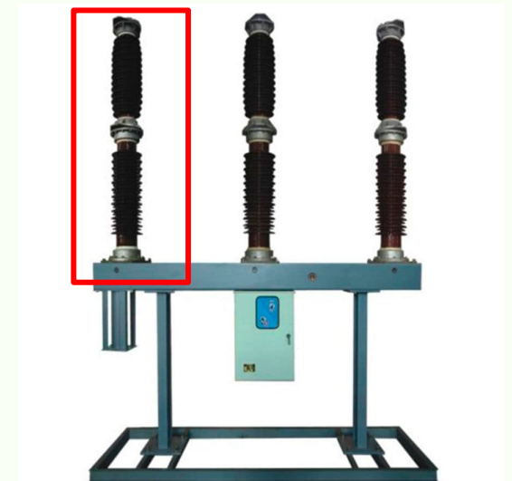
Disjoncteur HTB 90 kV
